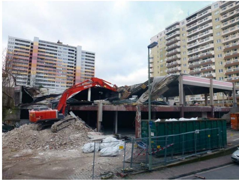
Typische Entsorgungssituation von Bauschutt heute: Kaum Dämmung, aber Massen von Massivbaustoffen. Die Mineralwolle der Flachdachdämmung liegt vorne in den Bags.
