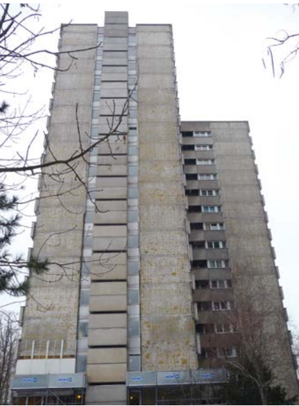
Betonspeichermassen eines Frankfurter Studentenwohnheims für 700 Studenten.
